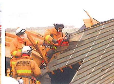
▲輪島市の倒壊した家屋における救助活動
